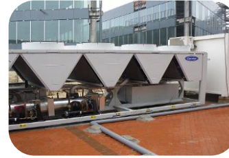
Instalaciones Terciarias Mecánicas
